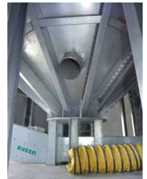
Воронка силоса с подключением вентиляции
