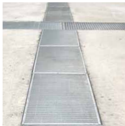
Grilaj deasupra canalelor de aerare
