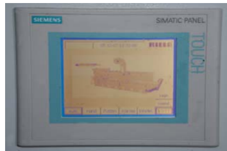
Schaltschrank mit SPS-Steuerung.
