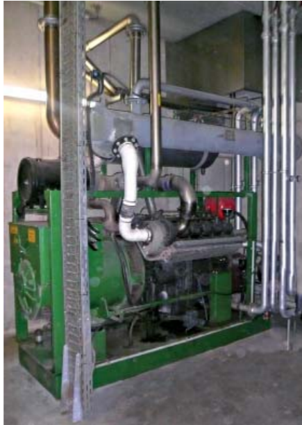
BHKW als Energieversorger des Schubwendetrockners.
